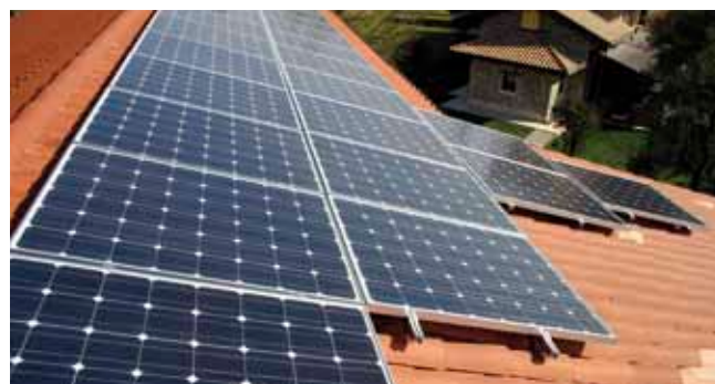
Fiume Veneto (PN) 5,96 kWp
