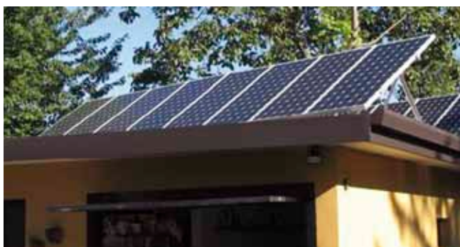
Udine (UD) 1,71 kWp
