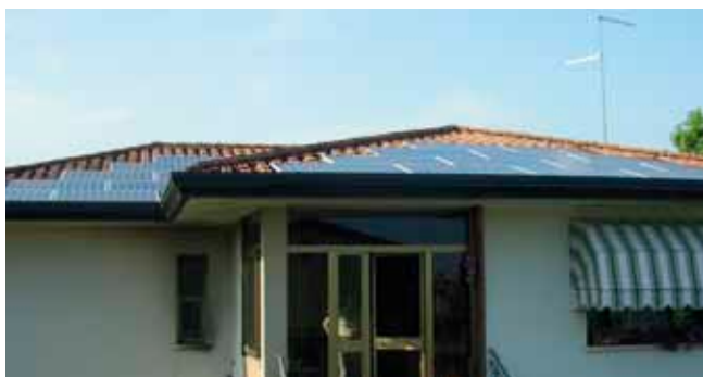
Morsano al Tagliamento (PN) 4,32 kWp
