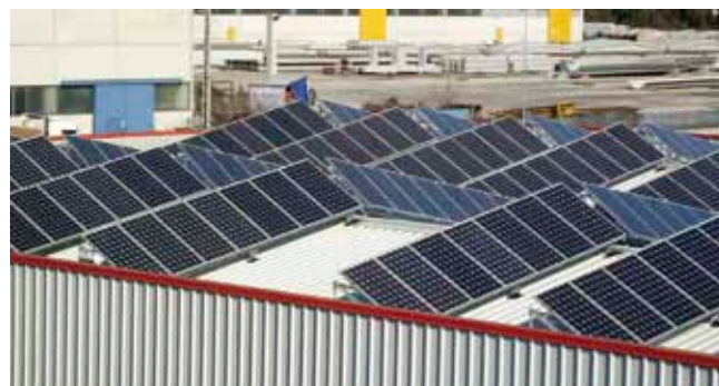
Martignacco (UD) 40,92 kWp
